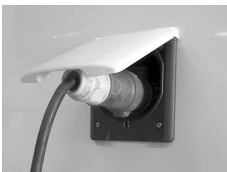
Fig. 2 : Branchement électrique sur le secteur
