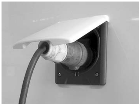
Fig. 56 : Branchement électrique sur le secteur
